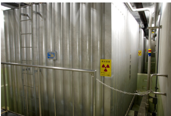
RI 排水設備
