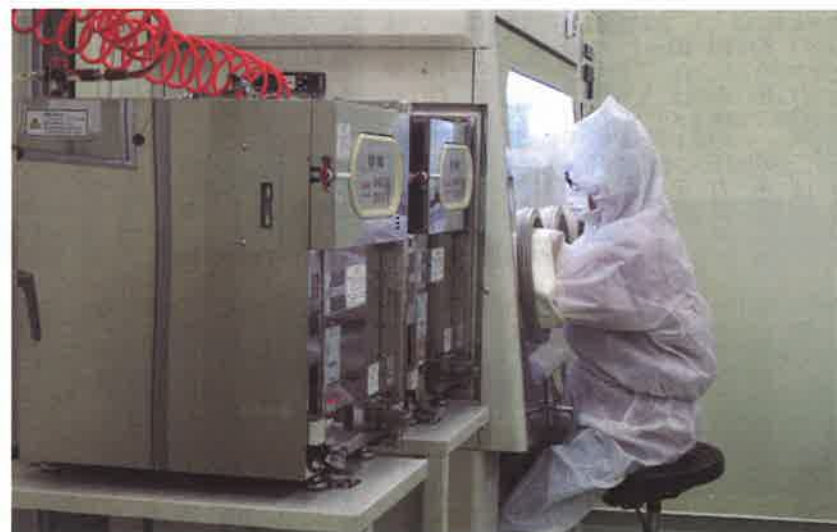
▲リサーチセンター地下2階クリーンルーム内にセルプロセッシング・アイソレータが導入され、GMP基準に準拠した細胞調製を可能とする細胞調製室(セルプロセッシングルーム)が2009年5月に完成した
